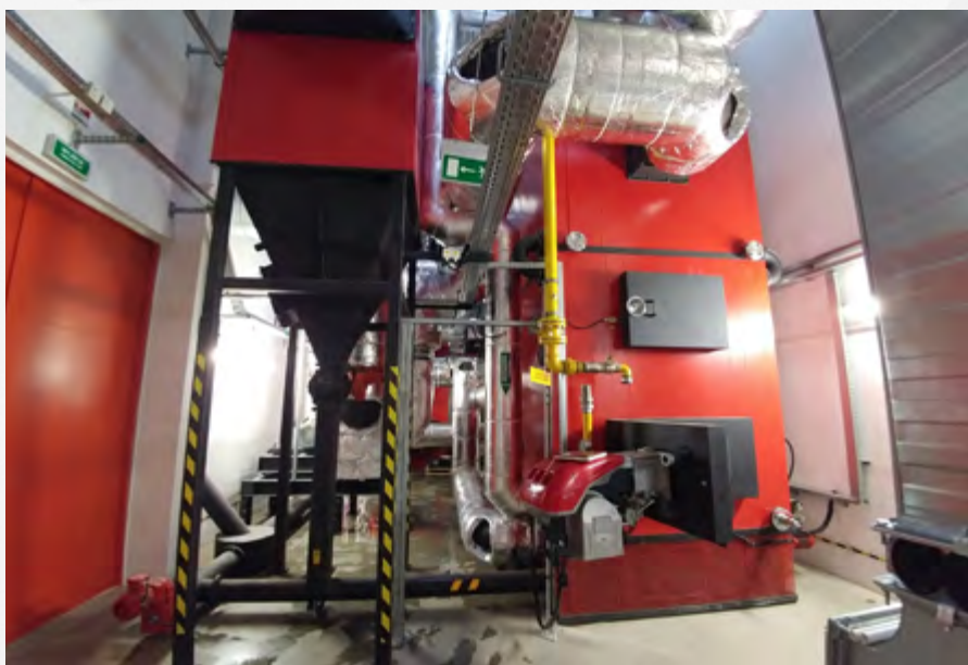
Kotłownia na odpady drewnopochodne - 3,3 MW / Boiler for wood waste – 3.3 MW
