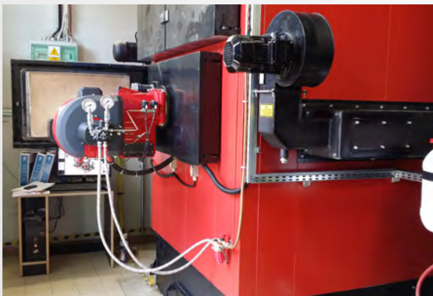
Palnik wspomagający proces spalania / Burner supporting the combustion process
