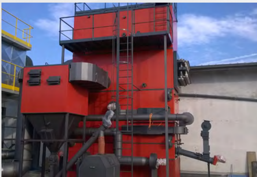
Kotłownia parowa na agropellet - 3 MW / Steam boiler for agro pellets – 3 MW
