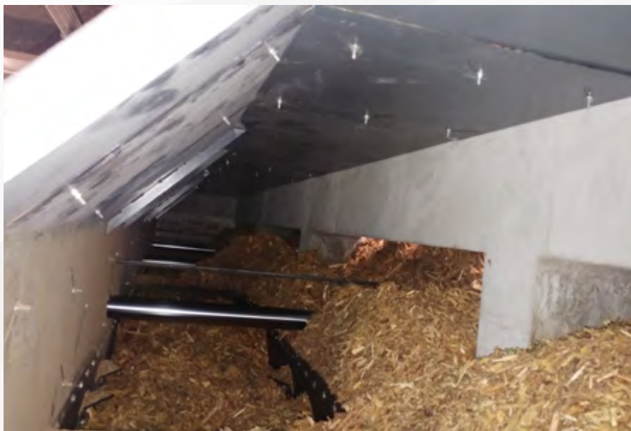
Ruchoma podłoga - transport i magazynowanie mokrego paliwa / Burner supporting the combustion process
